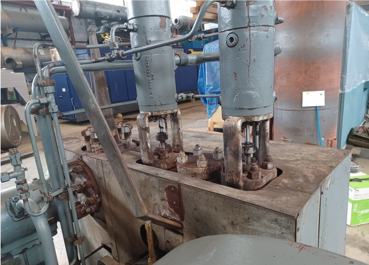
Dampfeintritt mit Dampfsieb und Regelventilen
