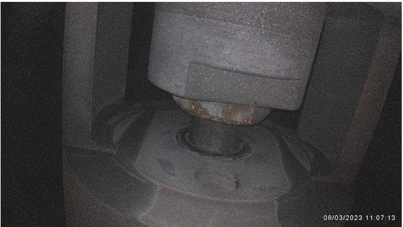
Ventilspindel Schnellschlussventil mit Riefen und Beläge auf der Spindel
