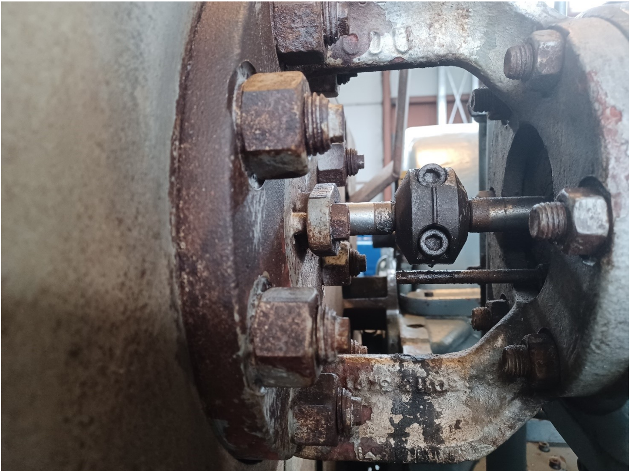
Regelventilspindel mit Riefen und Ablagerungen
